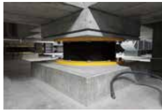
地下に設置された免震ゴム
